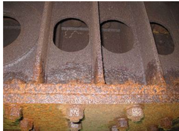
図 6.6 金属劣化の事例
