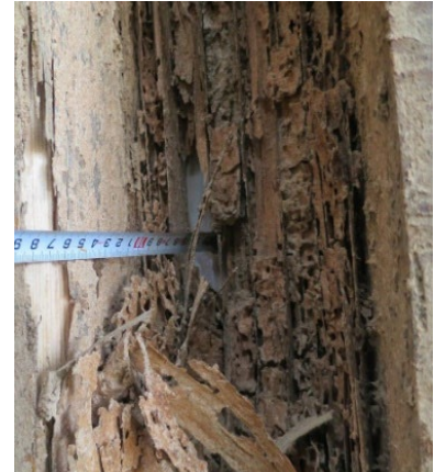
図 6.4 蟻害を受けた柱
