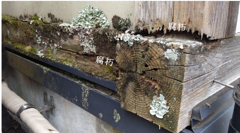
図 6.3 腐朽した柱脚と土台
