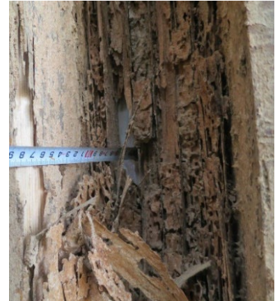
図 6.4 蟻害を受けた柱
